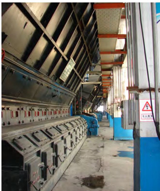
项目安装的8台70MW高温热水锅炉及辅机
