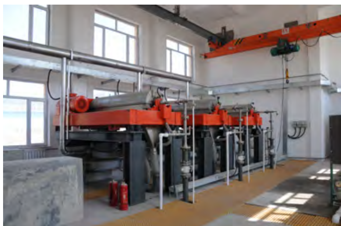
项目购置的脱泥机设备
