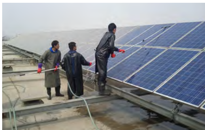
屋顶光伏电站实训基地
