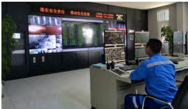
工作人员在中控值班室监控焚烧线运行状态
